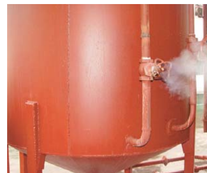
Fugas de vapor. En tuberías y en calderas.
