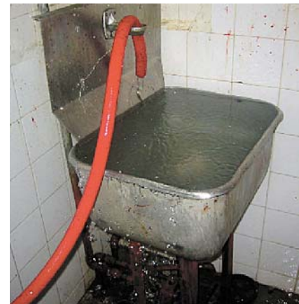
Manguera con fugas y sin pistola de presión.
