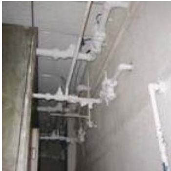
Tuberías sin aislamiento. Esta práctica produce pérdidas por consumo de combustible.
