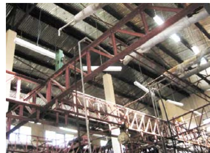
Iluminación de un matadero industrial.
