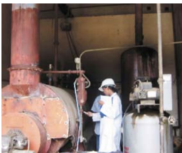
Control permanente de caldera.
